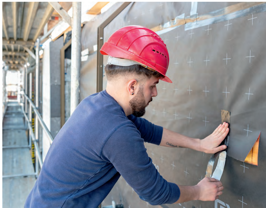
^ Isolation und Windschutz sieht man zwar nicht – doch sie sind umso wichtiger.
