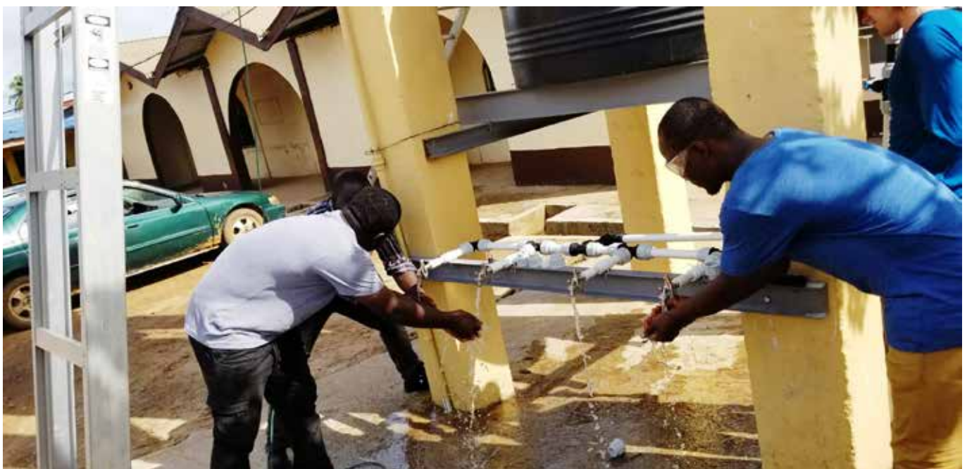
Das saubere Wasser fliesst: Die GDM-Anlage wurde in einen bereits vorhandenen Grundwasserspeicherturm eingebaut.
