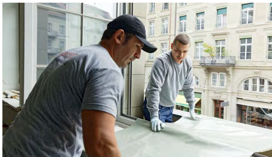
Die Berufsleute decken das Fensterbrett ab, über das später der Pumpenschlauch mit dem Fließboden gezogen wird.
