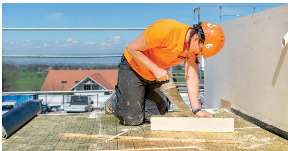
▲ Vor dem Abdichten schneidet Svenja German das Isolationsmaterial zu und installiert es.
