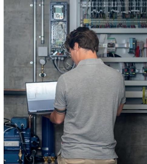
Der Kältesystem-Planer kontrolliert die Parameter des Programms, das das Kältesystem steuert.
