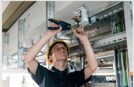
Geräte anschliessen Die Elektrokomponenten müssen nicht nur installiert, sondern auch ans Stromnetz angeschlossen werden – z.B. Schaltungen, Steuerungen oder Zähler.
