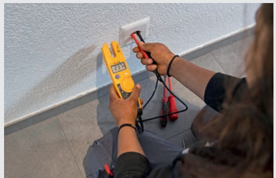
Anlagen testen Unter Anleitung von Elektroinstallateur/innen prüfen die Berufsleute, ob der Strom richtig fliesst und die Sicherungsschalter funktionieren.
