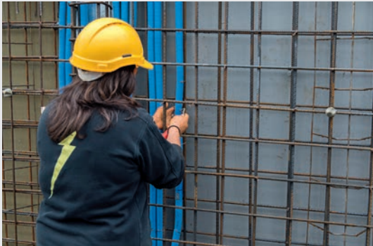
Rohre und Kanäle montieren Die Leitungsrohre werden meistens vor dem Betonieren der Wände und Decken verlegt. Seltener befinden sie sich an Mauern oder in Kabeltrassen.
