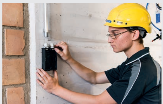
Unterhalt und Reparaturen Die Berufsleute sind gefragt, wenn in Haushalten oder Firmen ein Defekt auftritt oder wenn die Elektroanlagen eines Gebäudes veraltet sind.
