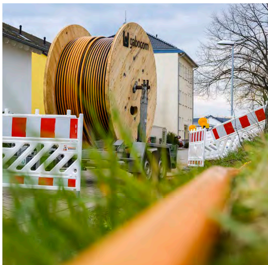
Fast 41 Prozent der Schweizer Haushalte sind mittlerweile mit Glasfaser erschlossen. Viele, vor allem rurale Gebiete, verfügen jedoch noch über keine oder schlechte «Datenautobahnen». Diesem Thema widmet sich Carmen Metzler in ihrer Masterarbeit in Geographie.
