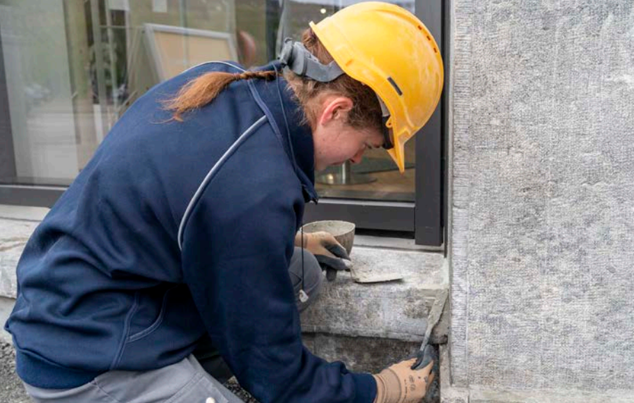
◀ Die Steinmetzin bessert eine brüchige Fuge an der Fassade mit Mörtel aus.
